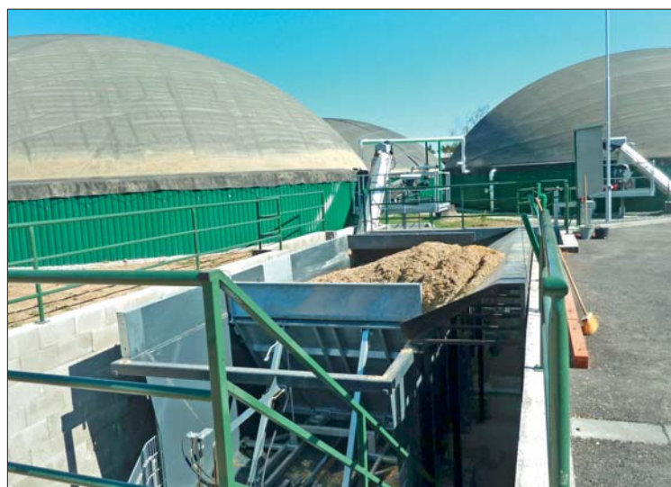
Bioplynová stanice ZD Haňovice je v provozu od loňského roku
